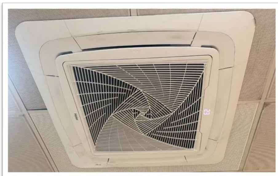
Fotografía de un nuevo split de techo
