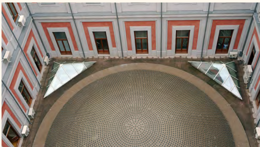
Estado actual de la cúpula de la Biblioteca Central de Hacienda.
